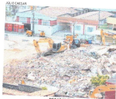
DESABAMENTO do Edifício Andrea aconteceu em outubro de 2019
