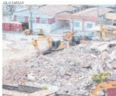
DESABAMENTO do Edifício Andrea aconteceu em outubro de 2019
