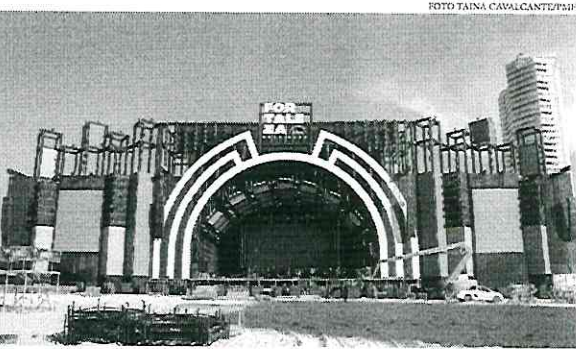
O palco de 74 metros de largura e 22 metros de altura começou a ser montado no início de dezembro
